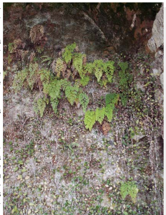
Capillaires sur le mur intérieur. Photo : B. Wattez
